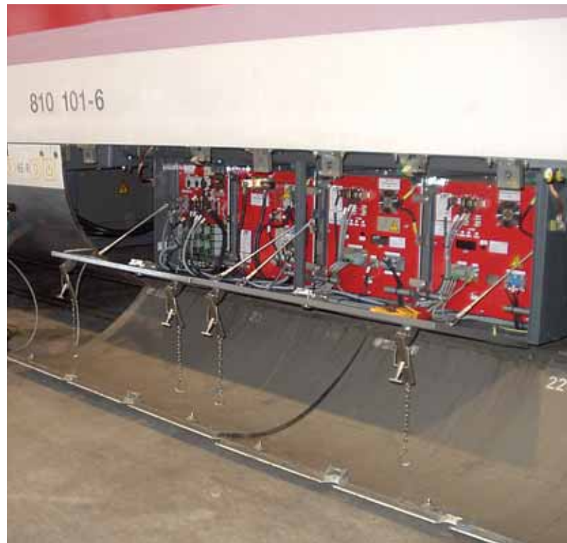
Energieversorgungssystem MEE-NT LD im Messwagen 810 101-6
